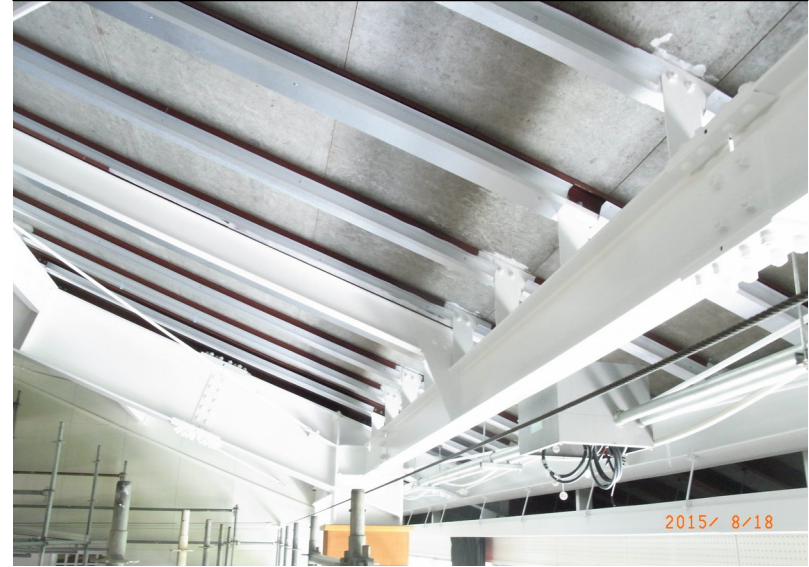
オープンスペース取り付け②
